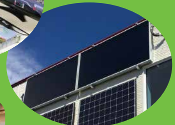
太陽光パネル
